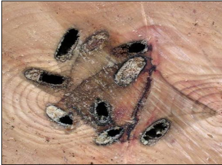
Figura 8. Galerías limpias de aserrín. Fuente: Rojas y Gallardo (2004).
