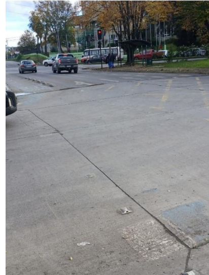
Figura 4.4: Atravesio de calzada R. Freire en mal estado, con desgaste total de demarcaciones.
