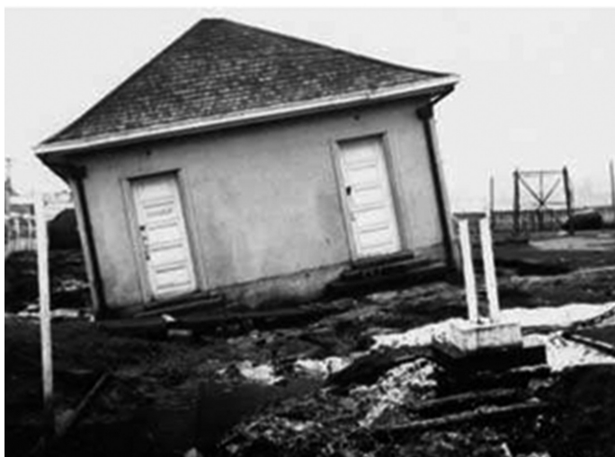
Imagen 2. Casa removida de su base a consecuencia del terremoto, 1960
